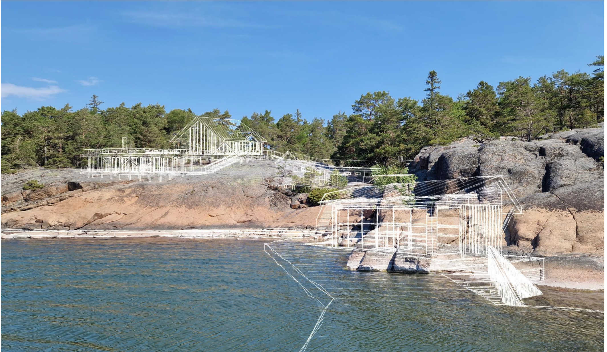
Uusi ravintola ja paviljonki, suihkurakennus, savusaunan katto, rantasauna, laituri ja portaat merivesialtaaseen - havainnekuvat
